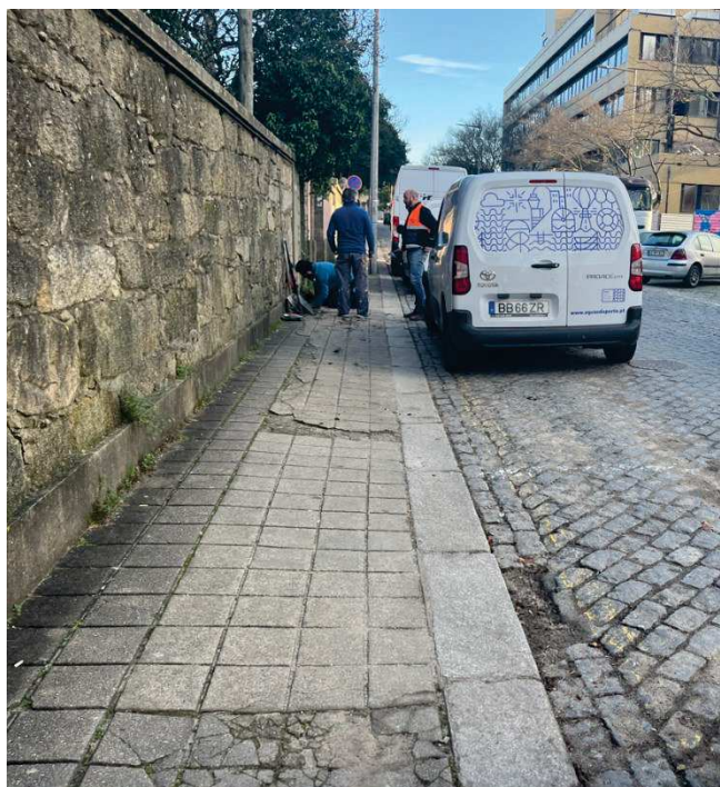
Figura 2 – Passeio bastante danificado.
