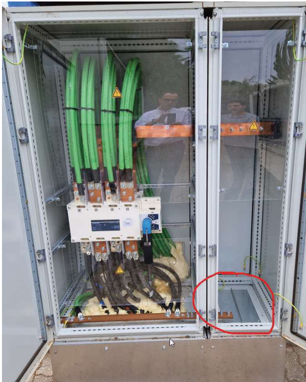
Fotografia 6- Entrada de cabos
