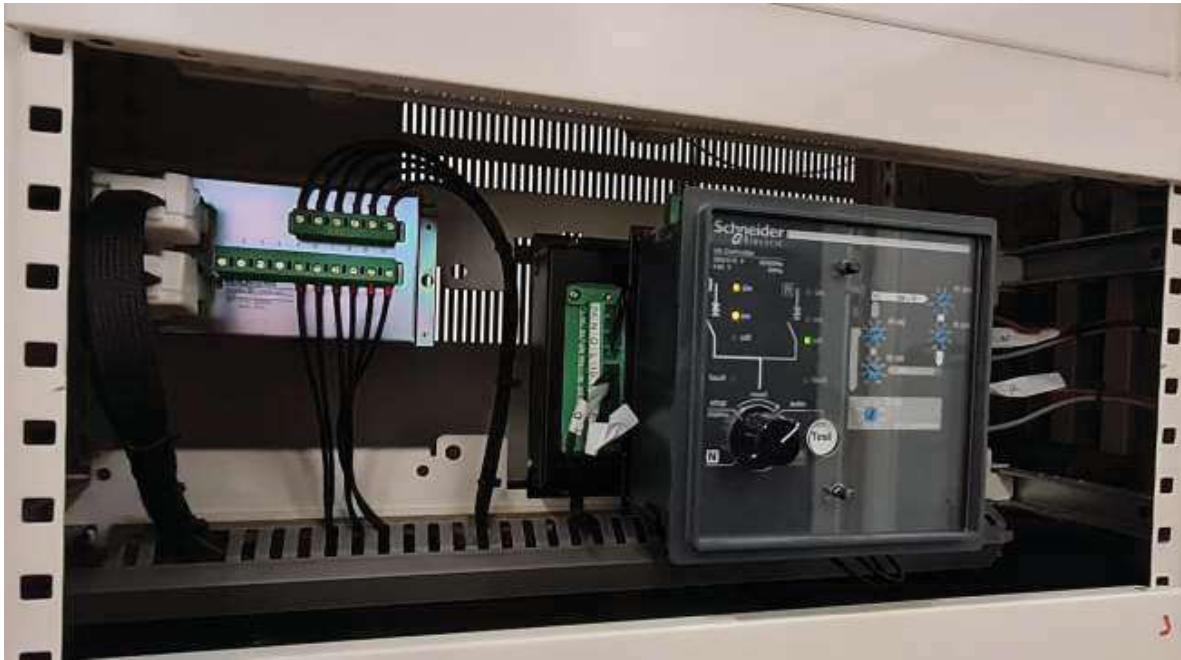
Fotografia 7- Autômato existente para arranque gerador
