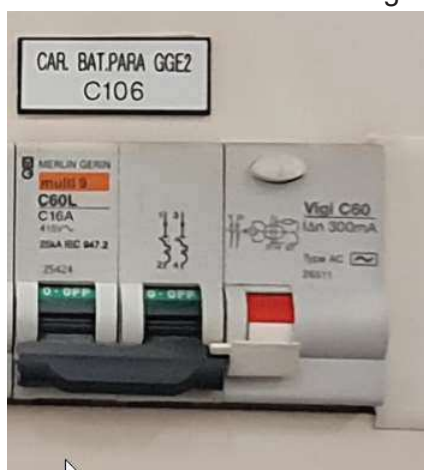
Fotografia 3- Circuito para carregador de baterias e aquecimento motor
