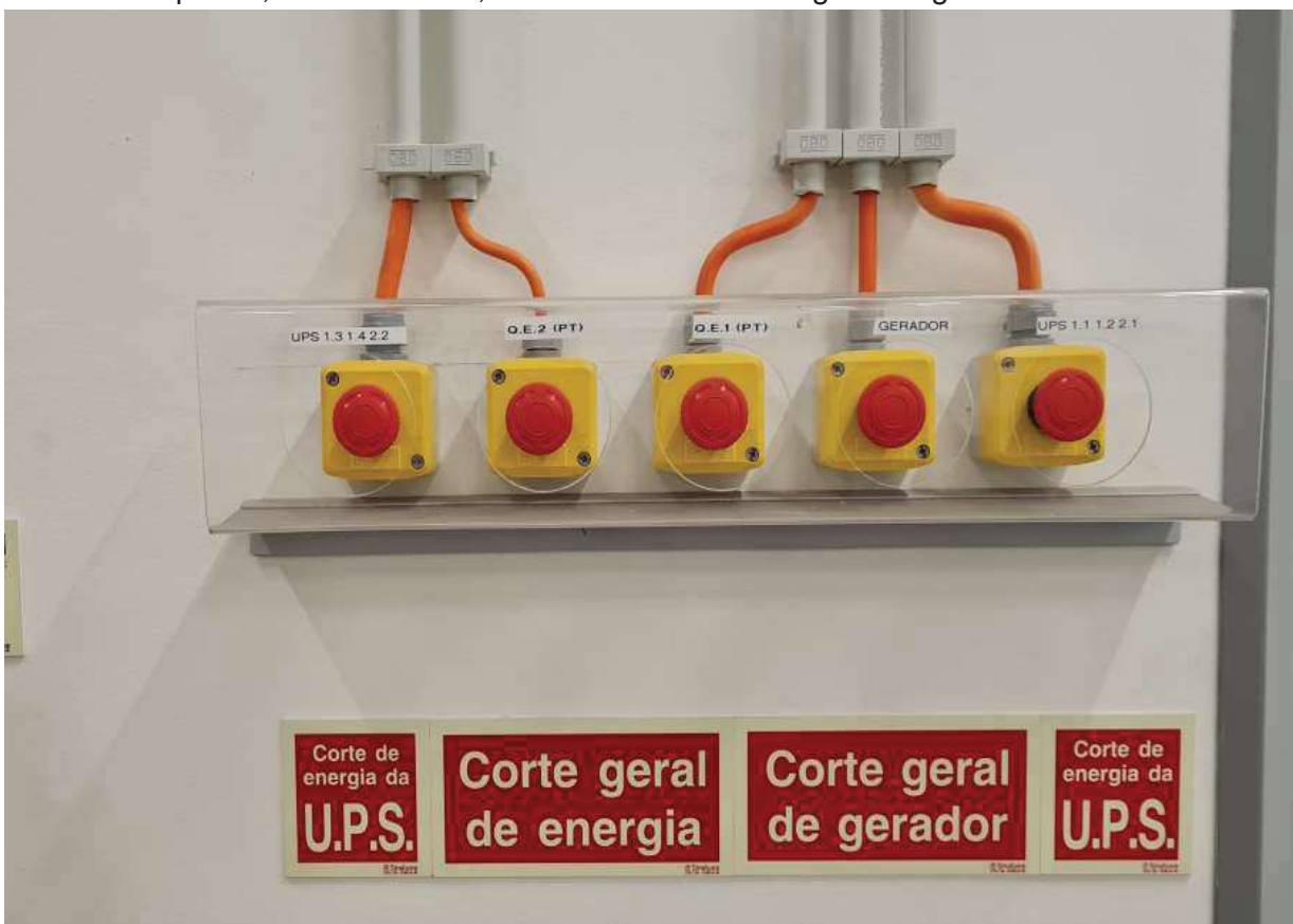
Fotografia 8- Botoneiras de corte de emergência
